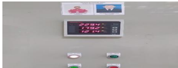
Gambar. Power Meter pada panel MDP
