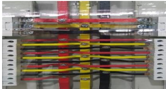
Gambar. Contoh Busbar pada Panel Listrik
