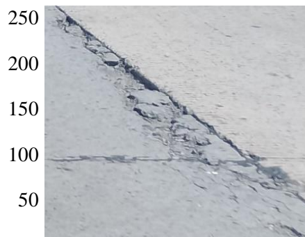
Gambar 4. Citra Kerusakan Beton.
